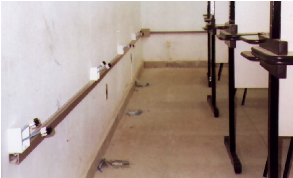
Figura 13 - Trecho de uma estrutura de passagem com as tomadas ainda abertas.
