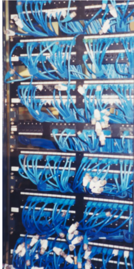
Figura 01 - Patch Panels sem identificação, 312 no total.
