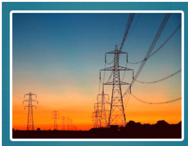
Figura 02 - Redes de distribuição de energia elétrica
